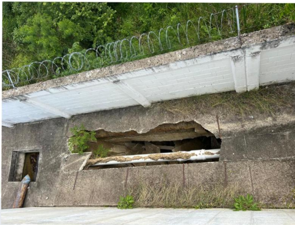
Fotografía 4. Vista del estado interno sobre el tanque No. 3 en la planta de El Prado
