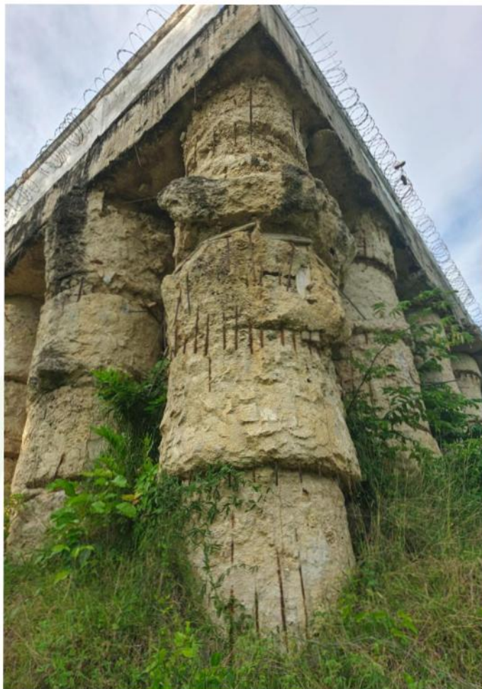
Fotografía 1. Perfil de los Caisson del lateral del tanque No. 3
